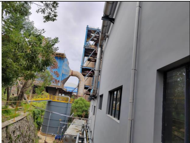
污泥预处理综合车间臭气收集管道
