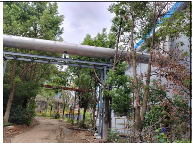
污泥预处理综合车间臭气收集管道
