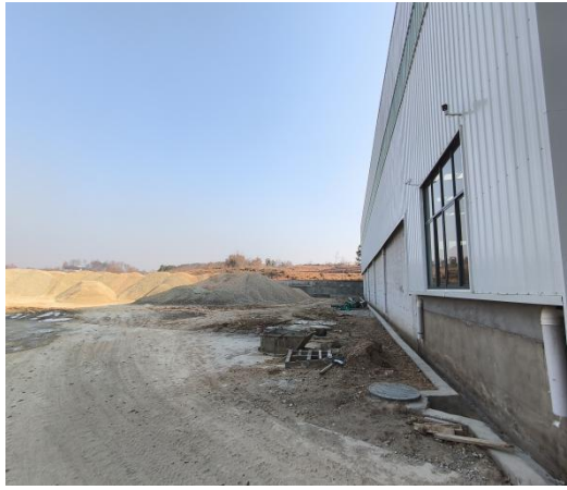
车间外雨水系统
