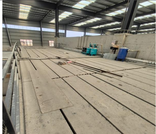
生产废水处理站
